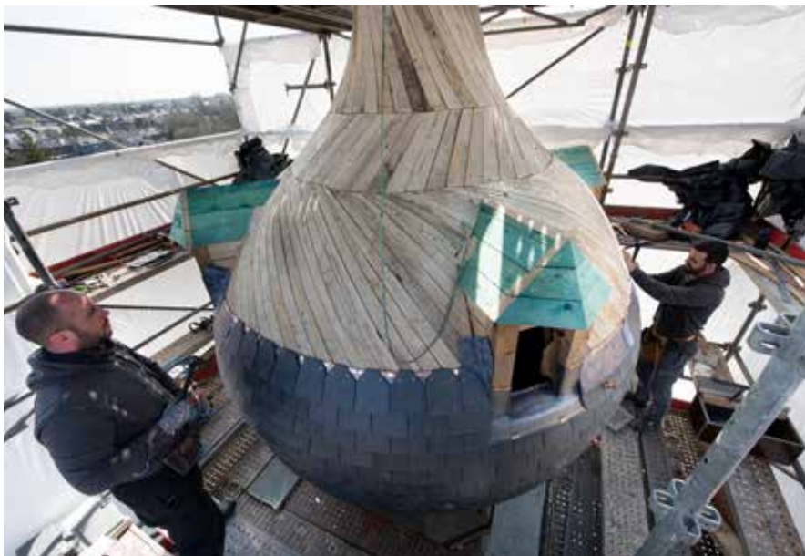
Vue sur le voligeage en peuplier croisé en deux nappes et ardoisage sur bande de plomb à ourlet plein.
